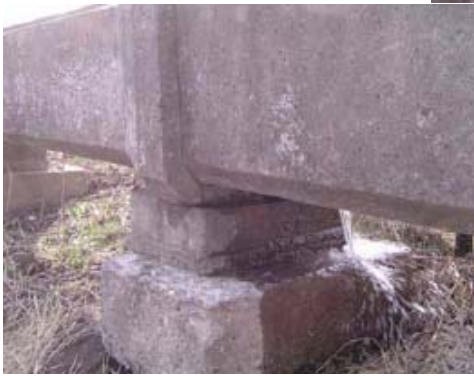
二次製品用水路の目地部からの漏水
